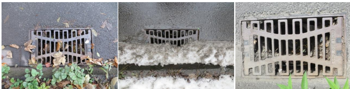
Abbildung 10: Sichtprüfung Gussrost Anlage 1 (v.l.n.r. November 2014, Januar 2015, Juli 2015)
