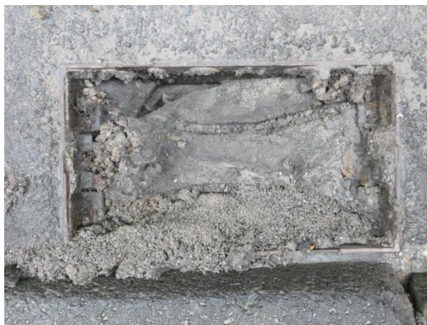
Abbildung 9: Verschmutzte Anlage 2 durch Belastung der Baustelle (18.08.2015)
