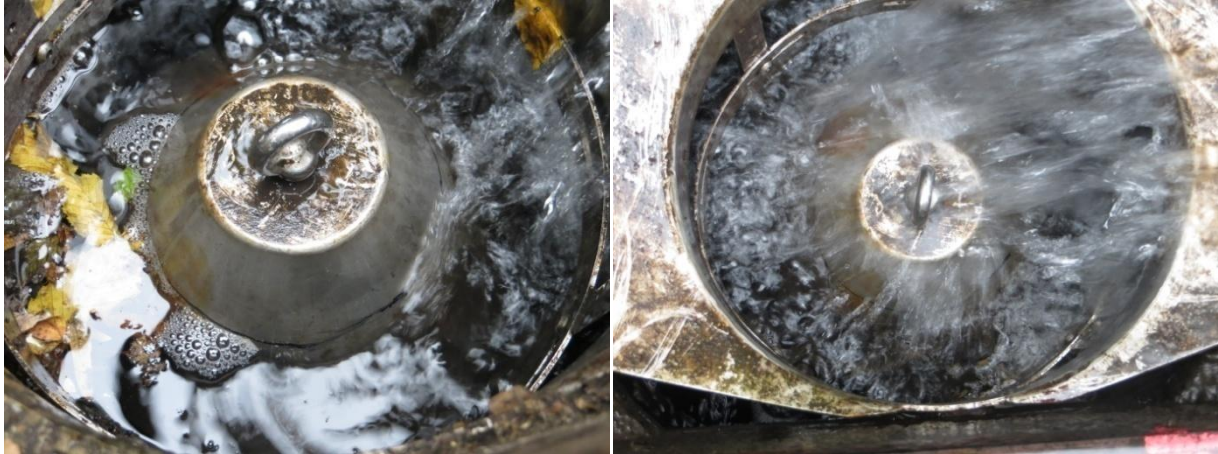
Abbildung 20: Hydraulische Leistungsprüfung Anlage 1, Links: Vor der Reinigung, Rechts: Nach Reinigung und Austausch des Filtersubstrates (29.10.2015)
