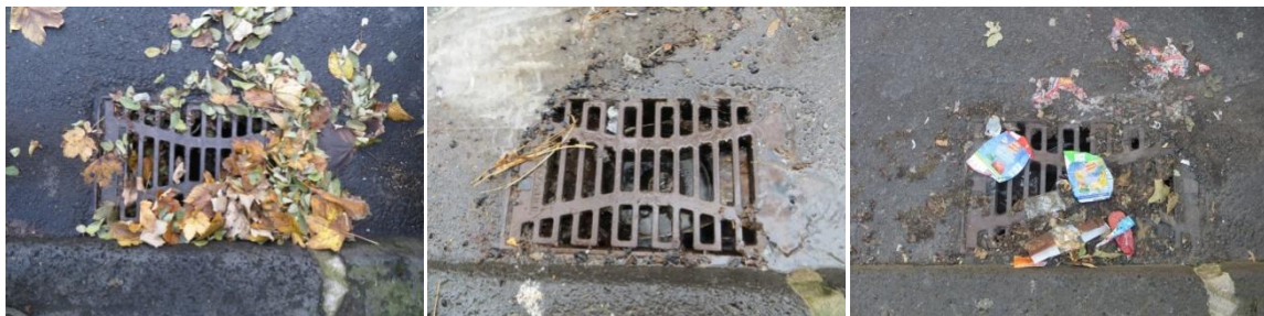
Abbildung 11: Sichtprüfung Gussrost Anlage 2 (v.l.n.r. November 2014, Januar 2015, Juni 2015)
